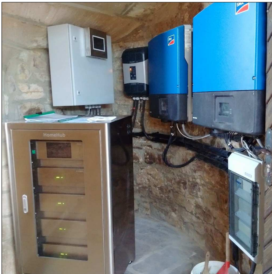
Abbildung 24 Wechselrichter und Batteriespeicher im Glockenturm (Quelle: Energie 2000)
