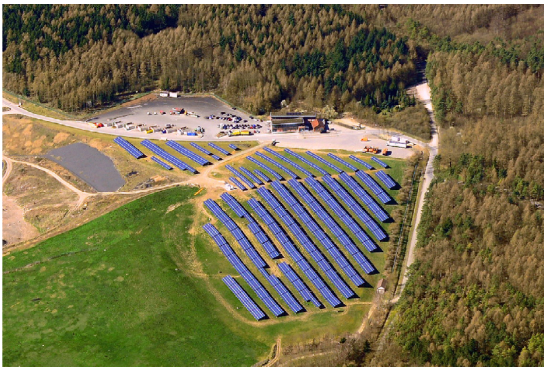
Abbildung 4 Photovoltaikanlage Deponie Kirschenplantage (Abfallentsorgung Kreis Kassel) 6
